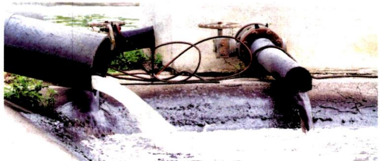
PEMBUANGAN sisa tercemar ke sungai akan dipantau menerusi penggunaan meter khas. – GAMBAR HIASAN
